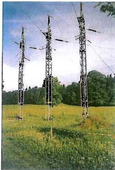
Bild 1. Herkömmlicher Provisoriumsmast mit Abspannungen
